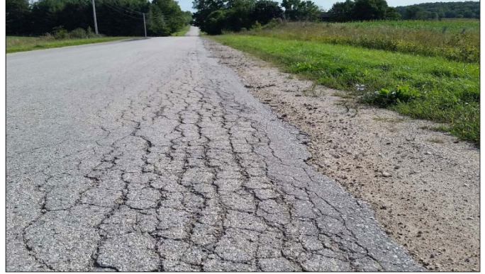
Edge alligator cracking
